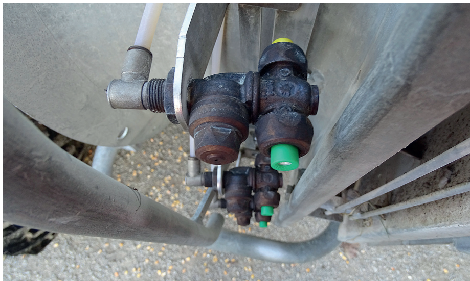
Na vsaki strani pršilnika je devet dvojnih šob s protikapnim ventilom. Šobe so Lechler, keramične.
